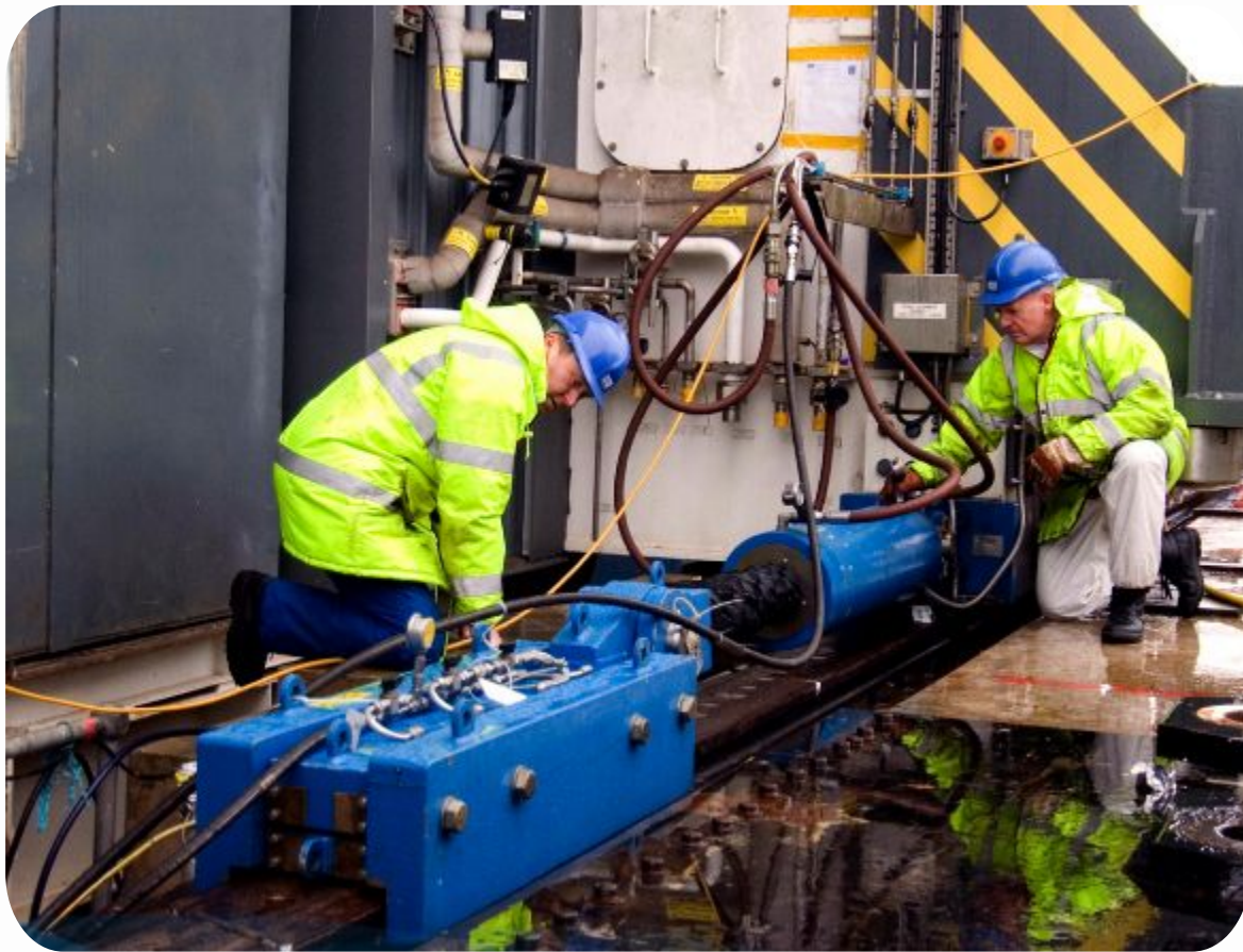
Equipos de arrastre hidráulico
